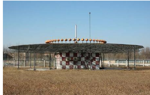
Gambar 2 Station DME di darat
